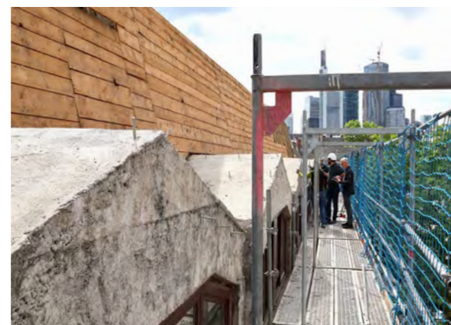
Baubesprechung auf dem Fassadengerüst in luftiger Höhe. Statt vier wird das Spenerhaus nach der Sanierung fünf Etagen haben.
